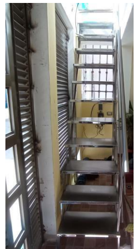
Escaleras de acero inoxidable
